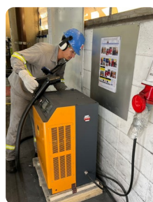
バッテリー充電設備
